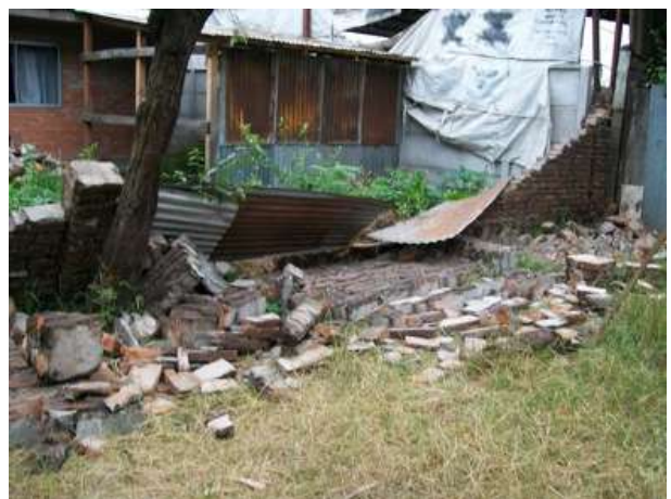
Erdbebenschäden in La Aurora, Lautaro/Chile
